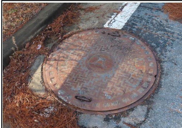
송수1 Sta.116+15.00(제수) 출입구 보호콘크리트 박리
