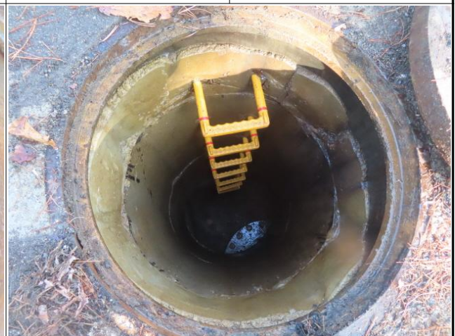
점검구실 사다리 설치 상태양호
