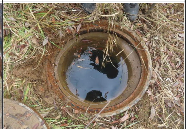
송수3 Sta.41+17.3(이토) 밸브실 침수(H=4.5m)
