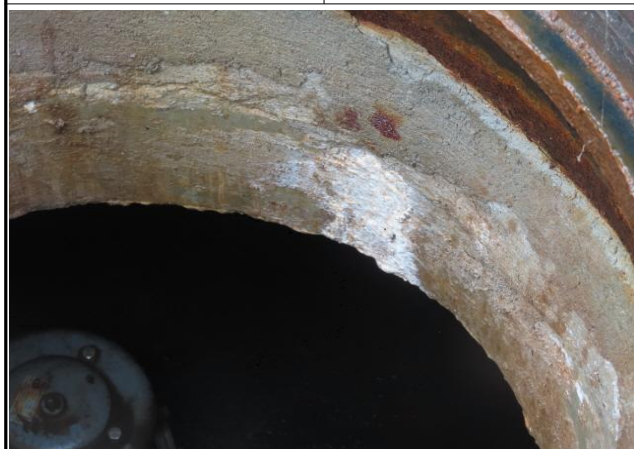
송수3 Sta.11+15.3(공기) 출입구 백태 발생
